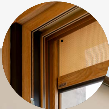
Cajón integrado en obra
